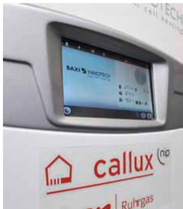
Das Display zeigt den Betriebsstatus und aktuelle Werte wie Wassertemperatur oder Stromproduktion.
